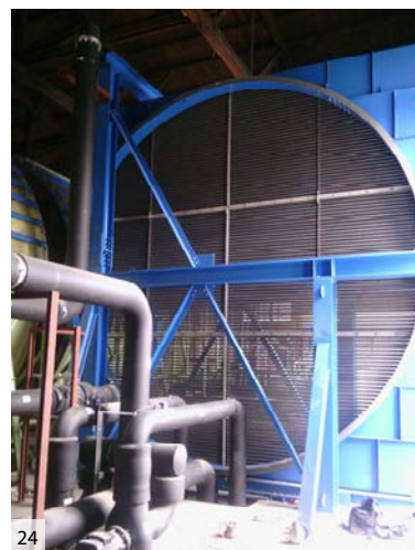
24. Vysunutý chladič aerodynamického tunelu o průměru 6m
