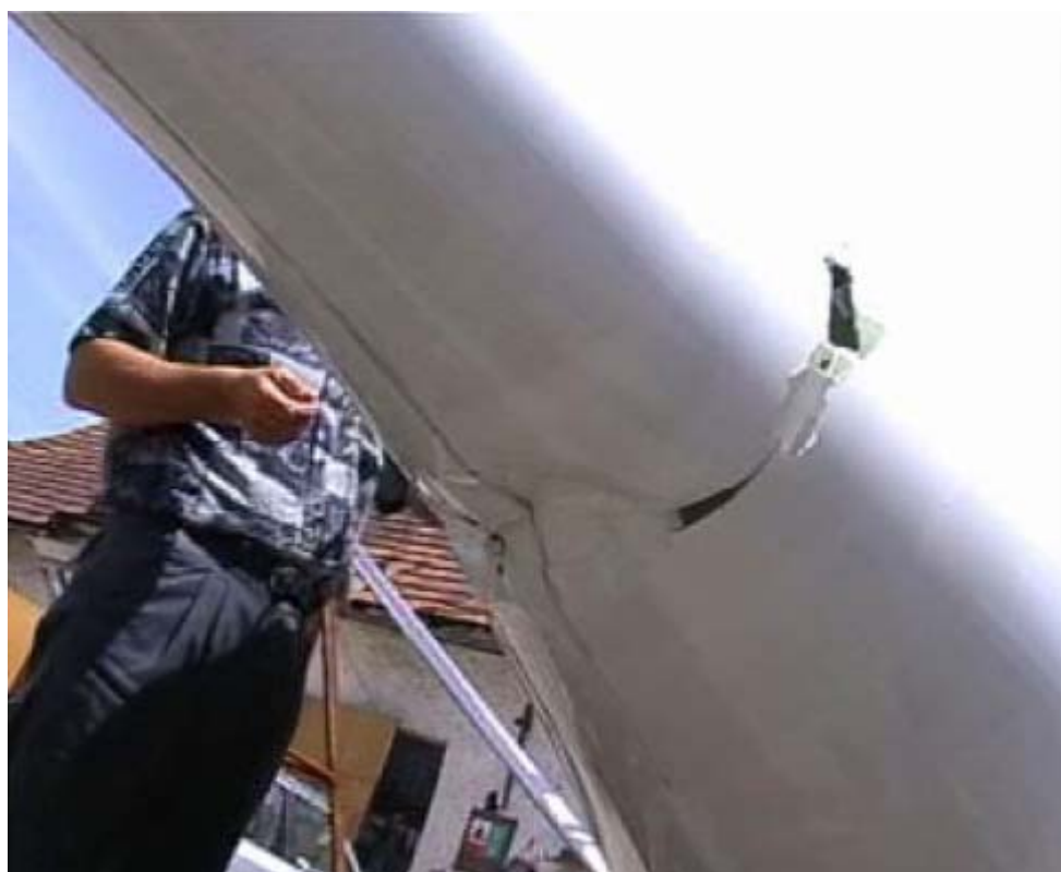
Obr.6 Kritické místo stabilitní poruchy zkouška
